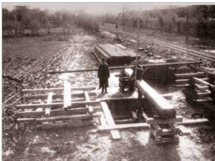
Auer, 1916. Mit dem antransportierten Schottermaterial wurde allmählich der Unterbau für das Bahnhofsdepot geschaffen, das sich auf einem sumpfigen Gelände befand. Rechts das Gleis, auf dem die Züge die Porphybrüche erreichten.
