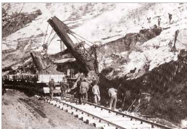
Auer, 1916. Ein Dampfbagger belädt die Güterwagen mit Schotter, der in Auer zur Anlage des Bahnhofs der Fleimstalbahn gebraucht wurde (insgesamt 180.000 cbm Schotter). Unter den Schienen sind die neuen Schwellen zu erkennen, die von den Militärschreinern aus den Stämmen gewonnen wurden, die ohne vorherige Benachrichtigung im Aurer Forchwald geschlagen wurden.
